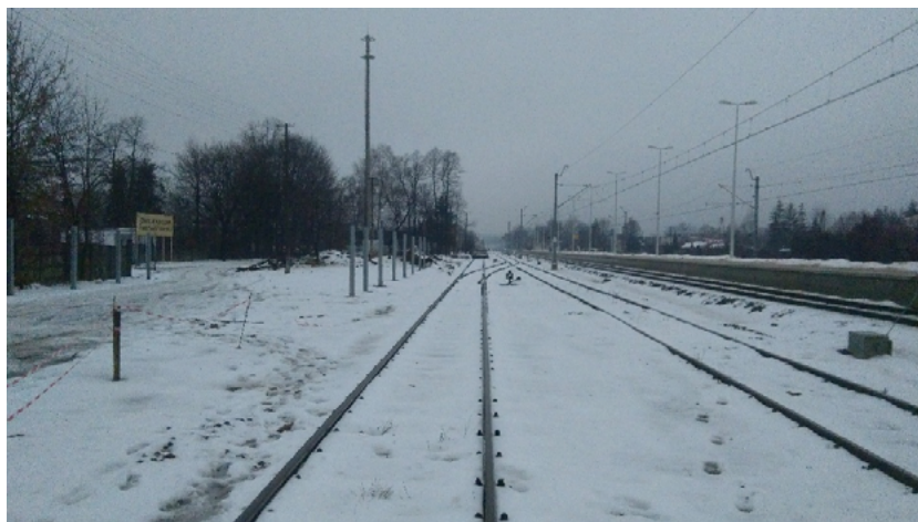
Zdjęcie 2. Niedokończone ekrany akustyczne na stacji w Poraju. Fotografia z wizyty monitorin- gowej 18 lutego 2021 roku. Źródło: materiały własne.
